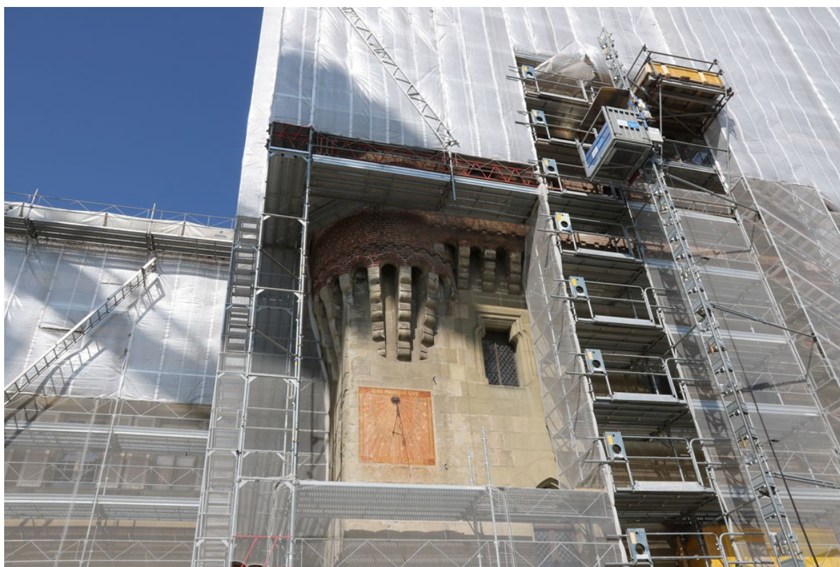
Fig. 1. Les 4 tourelles ont été dégagées des filets de protection avant l'arrivée des Martinets alpins. 23 mars 2016. L. Maumary.
