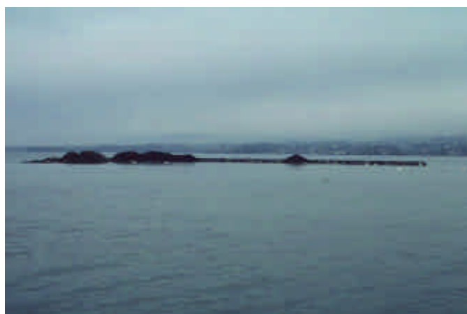
Fig. 11. A la fin de l'hiver, l'accès au chantier n'est plus possible en raison de la baisse du niveau de l'eau; l'enrochement est presque terminé et les matériaux en provenance de Meillerie acheminés. Préverenges, mars 2002. L. Vallotton
