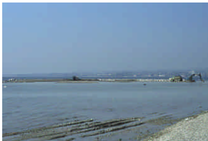
Fig. 19. La mise en place des matériaux de l'île a nécessité l'action coordonnée d'un trax, d'un «dumper» et d'une pelle «retro» pendant trois semaines. Préverenges, avril 2002. L. Vallotton
