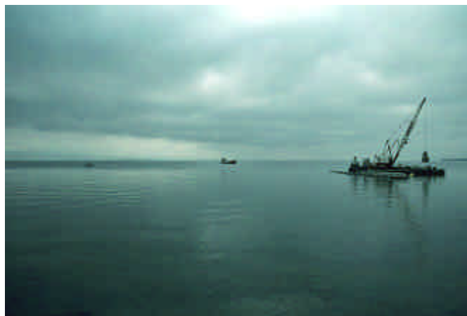
Fig. 10. Les matériaux sont déplacés de la barge, visible au loin, sur un ponton à faible tirant-d'eau. La pose des blocs s'effectue à l'aide de la grue, qui prélève les matériaux sur le ponton qui lui est accolé. Préverenges, novembre 2001. L. Vallotton
